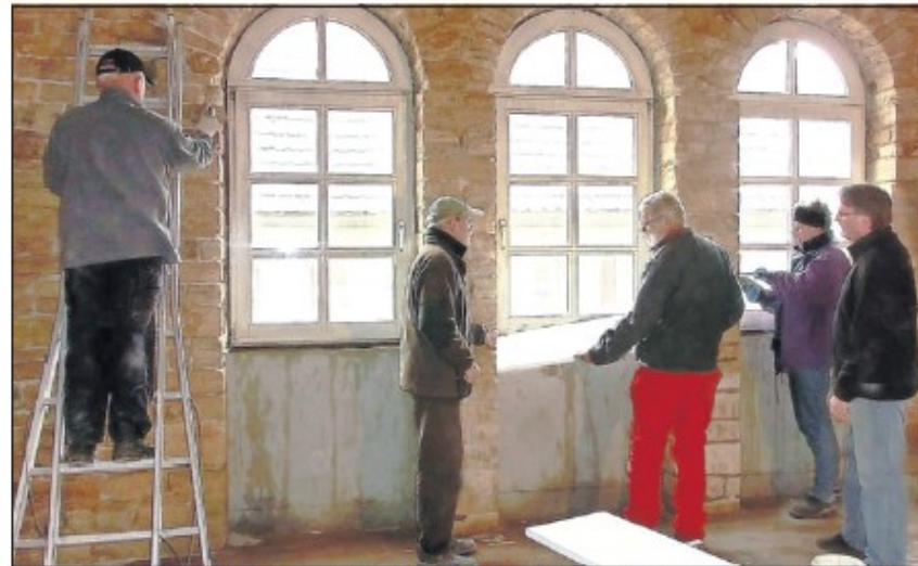
Im Blauen Rathaus: Karl-Heinz Bayer, Heinz Christ, Bernhard Ulrich, Paul Wiemer und Gunther Bechtel beim Ausfragen von Sichtmauerwerk und dem Setzen von Fensterbänken im künftigen Veranstaltungsraum im Obergeschoss an der Fensterfront zum Leinger Ring (von links).
